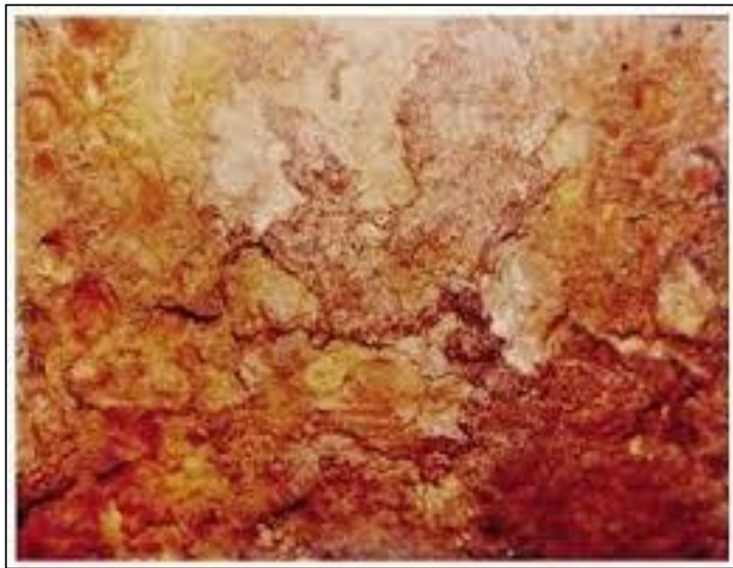
Figura 2 – Corrosão uniforme em uma chapa metálica
