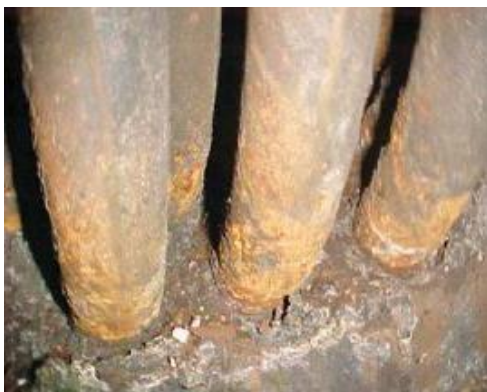
Figura 3 – ataque corrosivo nos pés do tubo
